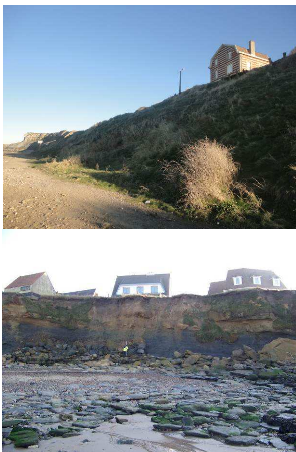
Figure 41 : Propriétés en arrière de la corniche de la falaise au nord de Wimereux (gauche) (Egis, Décembre 2013) et au nord d'Audresselles (DDTM62, 2013)
