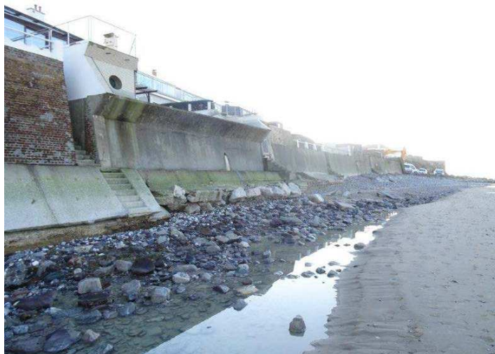
Figure 51 : Signes d'abaissement de l'estran et de l'affouillement du mur de soutènement à l'ouest de la digue (Egis, Hiver 2013-2014)
